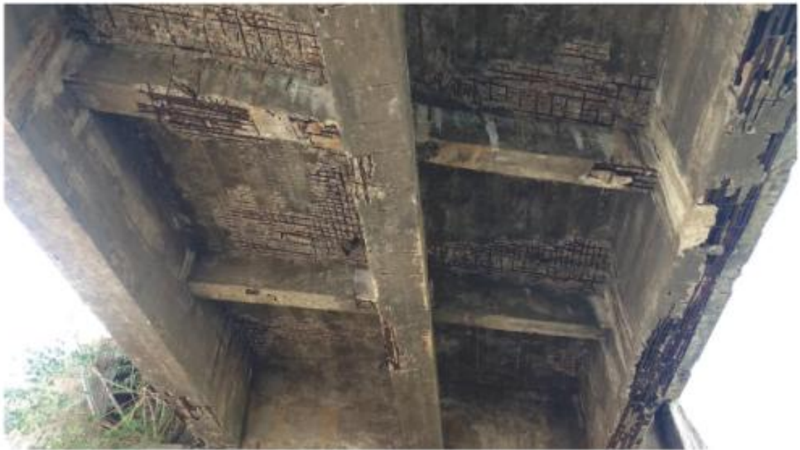
Figura 8 – Aspecto das transversinas e laje do tabuleiro: armaduras expostas, oxidadas e rompidas em vários trechos.
