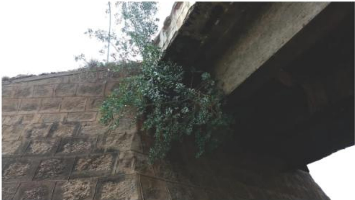
Figura 5 – Presença de vegetação nos encontros, evidenciando acúmulo de umidade, com fissuras próximas.
