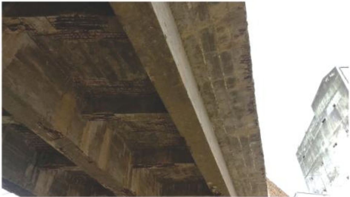
Figura 6 – Aspecto da viga de extremidade: pontos localizados de armadura exposta, situação menos precária que as demais vigas.
