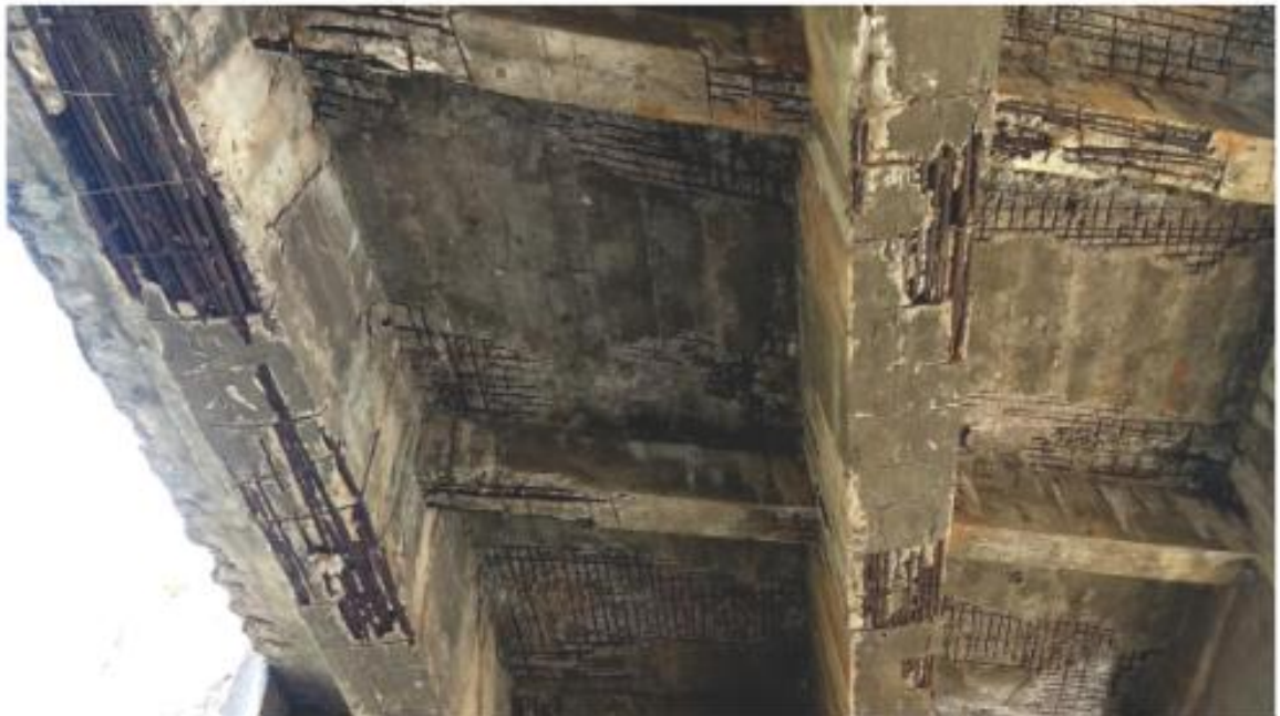
Figura 7 – Aspecto da viga central e da extremidade oposta: armaduras expostas, oxidadas, com redução de seção.
