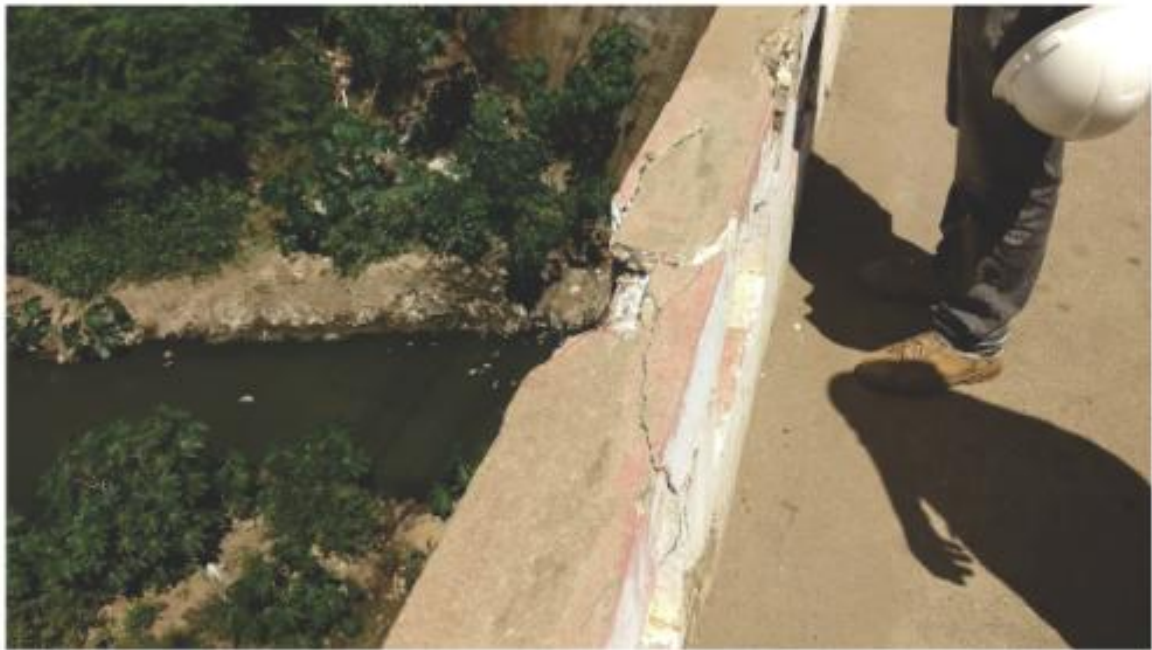
Figura 4 – Guarda-corpo do passeio apresentando armaduras expostas e perda do revestimento.
